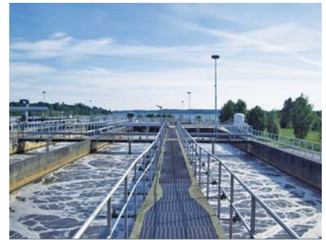
Die Verringerung von Treibhausgasemissionen und Energieverbrauch gehen zunehmend in die Planung neuer Kläranlagen ein. Das ISAH entwickelt hierzu innovative, energieeffiziente Techniken.
